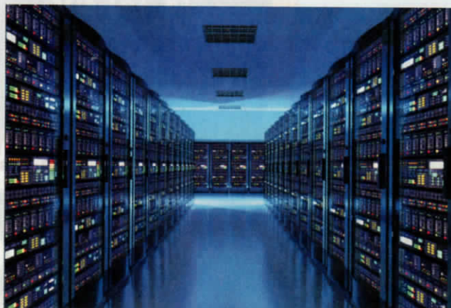
Les data centers, ou « centres de données », sont l'ossature d'Internet. Ce sont eux qui acheminent les données, les organisent, les traitent ou les stockent.
