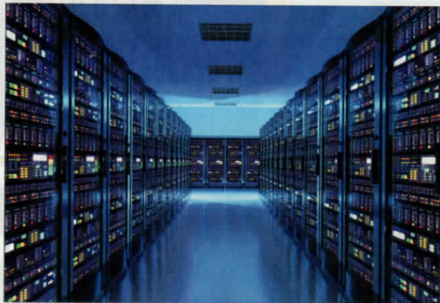
Les data centers, ou « centres de données », sont l'ossature d'Internet. Ce sont eux qui acheminent les données, les organisent, les traitent ou les stockent.
